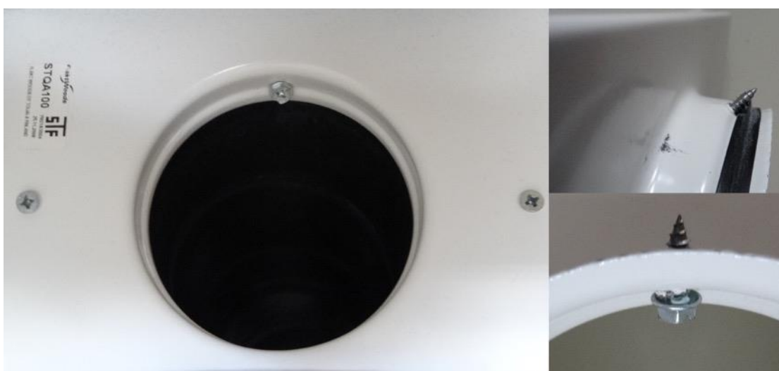
Figur 3.8 Exempel på vad en skruv på olämplig plats i tilluftsdon kan orsaka kraftigt ökat ljud (bilder från Kempe 2013, Kempe 2014b, Kempe 2017b).
