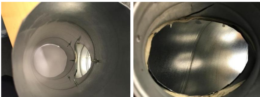
Figur 3.7 Bild på inklippt anslutning till tilluftsdon med vassa kanter i stället för ett förtillverkat T-rör, vilket gav höga ljudnivåer i rum.
